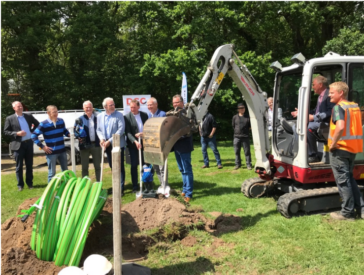
De schop in de grond, in Annen. Vertegenwoordigers van GB, Rendo, gemeenten, provincie, Rabobank en natuurlijk DGC; kraanmachinist: Meindert Krijnsen.
